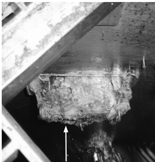
白く見えるのが油の塊です。下水道管が完全に詰っています。
