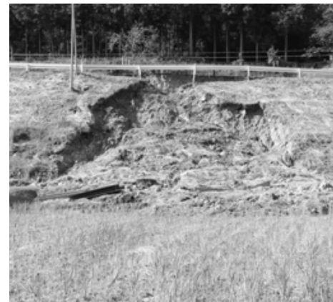
崩落した法面
