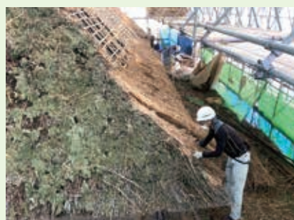
屋根の茅を下ろし、屋根として使える材料を選び分ける。下地の劣化を診断し、取替や藁を締めなおす。
