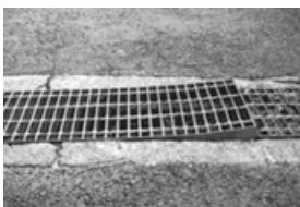
道路側溝蓋の破損
