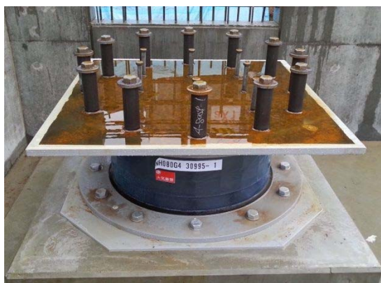
新庁舎地下に設置された免震装置
