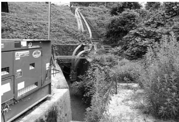
日下仮設ポンプ
