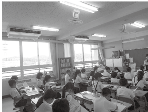
小学校の教室に設置されたエアコン
