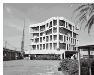
被災した宇土市役所
