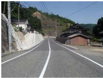
道路拡幅（市道三次山家線）
