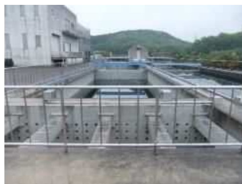
向江田浄水場1系沈殿池機械設備
