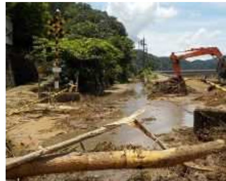
土砂が流入した芸備線 西三次駅構内踏切
