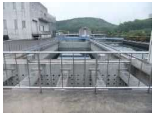
向江田浄水場1系沈殿池機械設備
