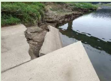
崩落箇所 (撤去済)
