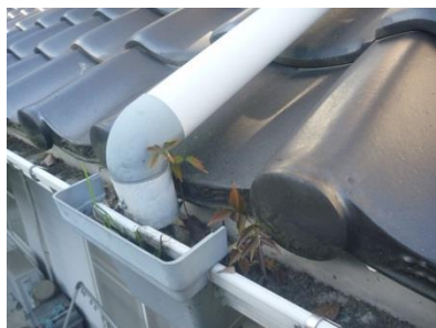
（雨樋のつまり）
