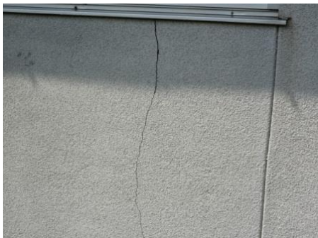
(外壁のひび割れ)
