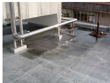
（受水槽の漏水）
