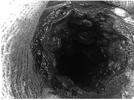
老朽管内の錆
