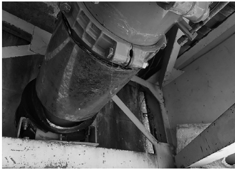
寺戸水道橋の漏水
