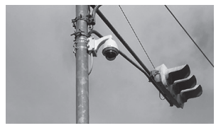
港交差点に設置した防犯カメラ
