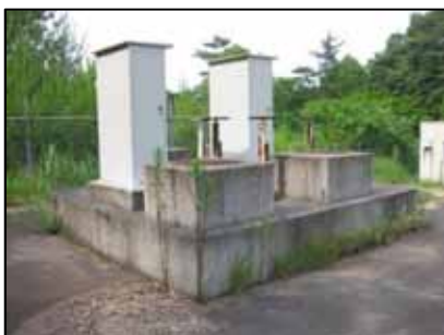
日南取水場(導水ポンプ井)
