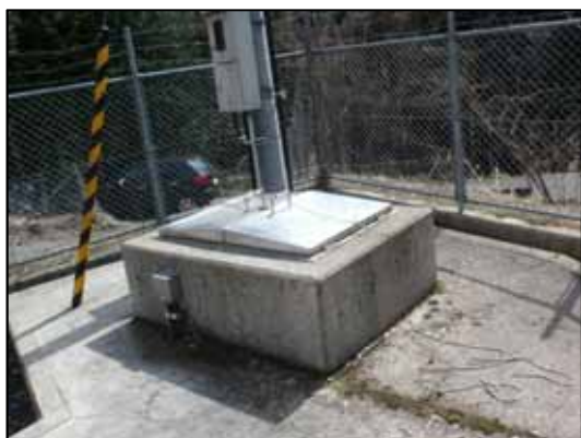
茂田浄水場(取水井)
