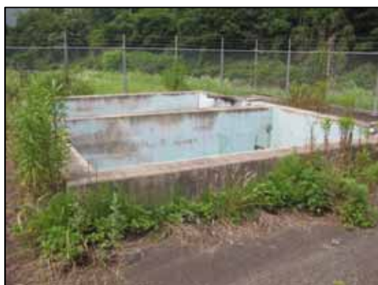
敷名営農飲雑用水浄水場(緩速ろ過池)
