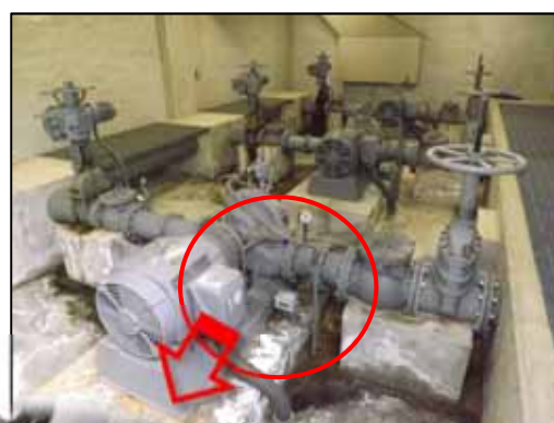
寺戸浄水場(送水ポンプの経年化状況)
