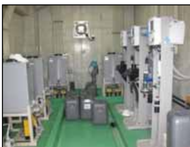
薬品注入設備と計器類
