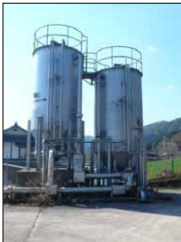
大仙浄水場(一次ろ過機)
