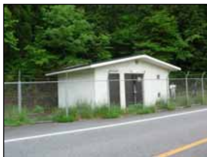
寺町加圧ポンプ所
