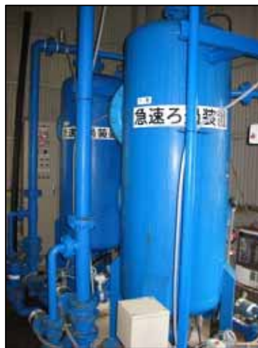
下板木浄水場(急速ろ過設備)
