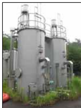
板木浄水場(急速ろ過機)
