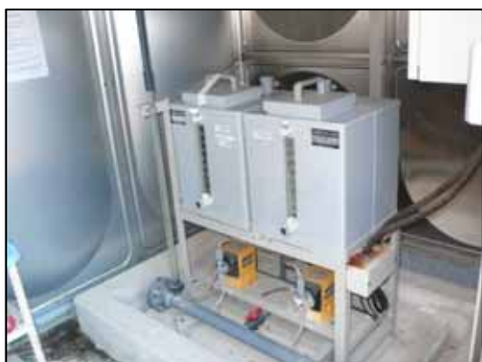
茂田浄水場(滅菌設備)
