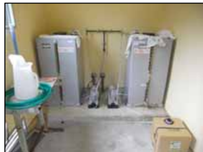
日南取水場(塩素注入設備)
