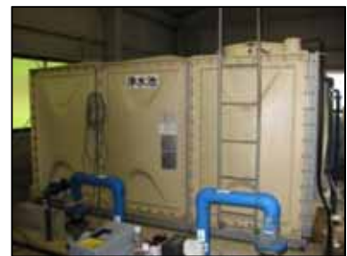
下板木浄水場(浄水池)
