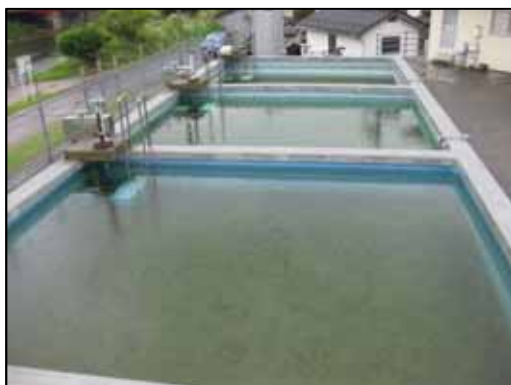
吉舎第1浄水場(緩速ろ過池)
