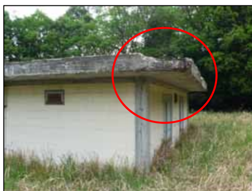
寺戸配水池(建屋屋根の経年化による破損状況)
