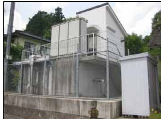
片野加圧ポンプ所
