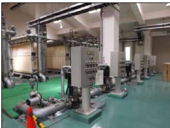
寺戸浄水場(膜ろ過処理設備)
