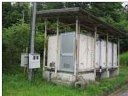
下板木高区配水池
