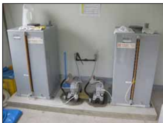
敷名営農飲雑用水浄水場(滅菌設備)
