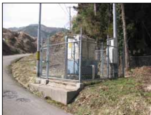
茂田加圧給水装置
