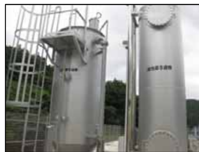
前処理ろ過機・活性炭ろ過機
