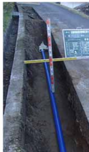
漏水管の修繕工事・老朽管の布設替え 漏水管を発見した場合、修繕工事により対応を図っています。また、老朽管は、漏水の原因となるため、布設替えにより、新しい配水管に更新しています。
