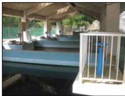
中野原浄水場 (緩速ろ過池)
