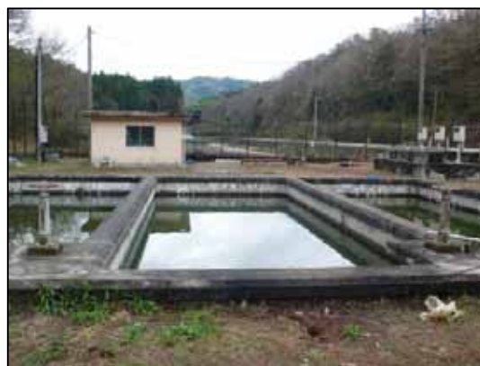
大掛浄水場(緩速ろ過池)
