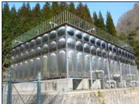
中野原配水池
