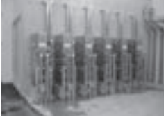
地中熱空調設備 (酒屋保育所)
