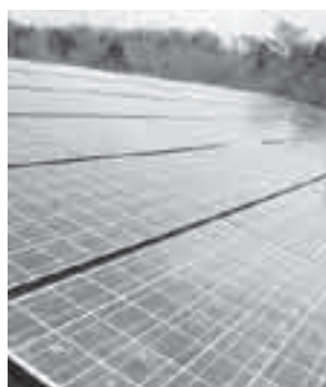
太陽光パネル
